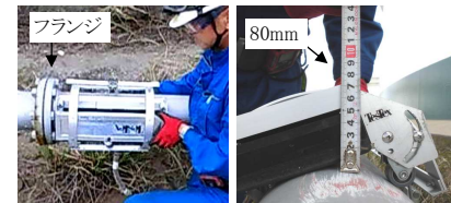
フランジ近傍の探傷(未探傷範囲なし)
